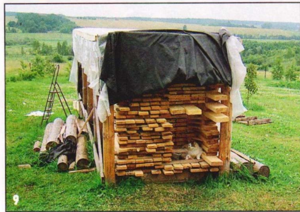
Теперь можно укрыть навес полиэтиленовой плёнкой. Если бы это сделали раньше, плёнку при заполнении навеса пиломатериалами легко можно было повредить. Плёночную кровлю по периметру навеса зафиксировали рейками. Так она лучше будет противостоять напорам ветра.
